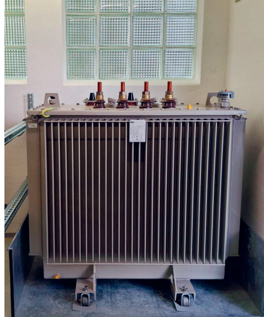
Der neu eingesetzte Trafo, wo er die kommenden 35 bis 50 Jahre seine Aufgabe erfüllen wird.
