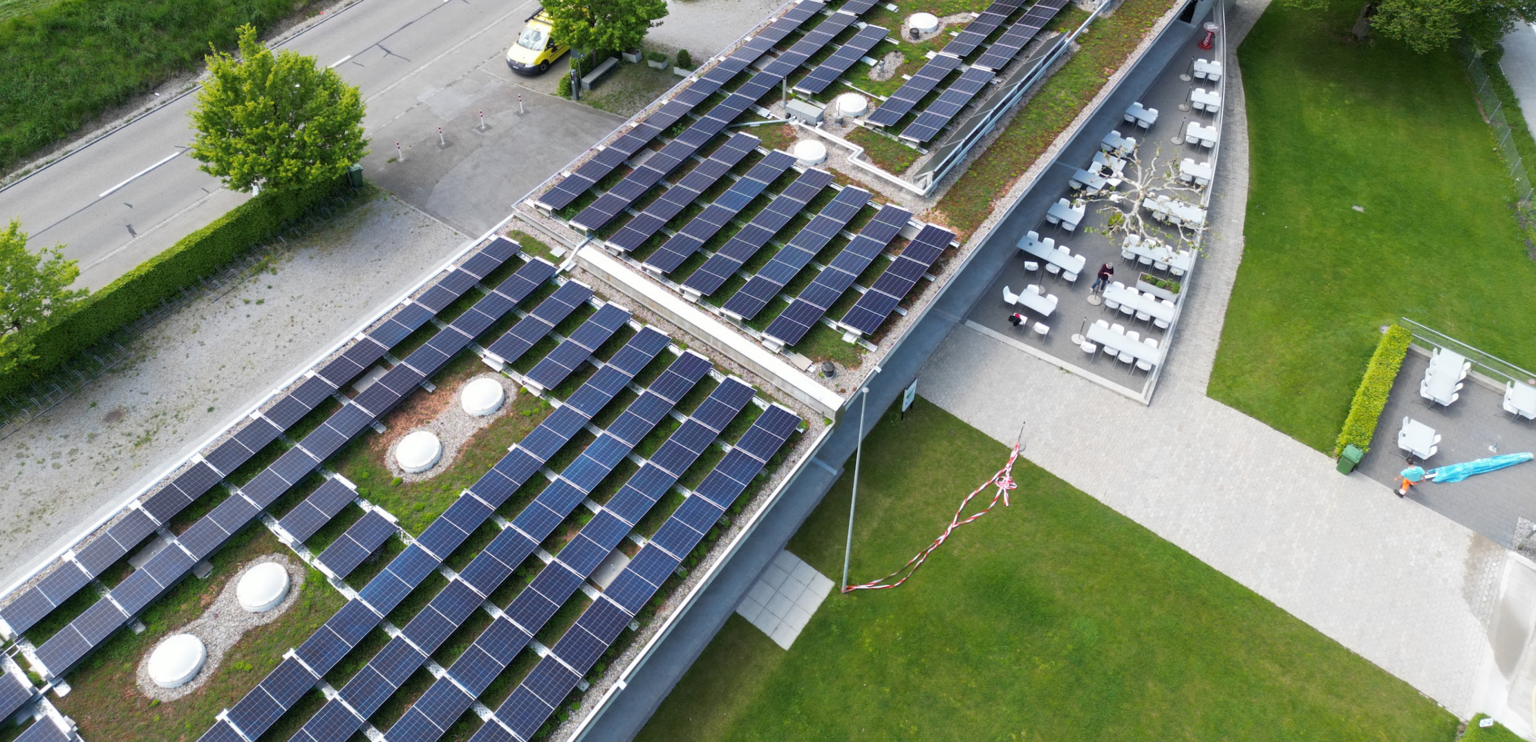
Die neue Photovoltaikanlage bei der Badi Böden.
