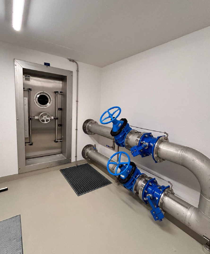
Ein Teil des Innenlebens des sanierten Reservoirs Magdenau.
